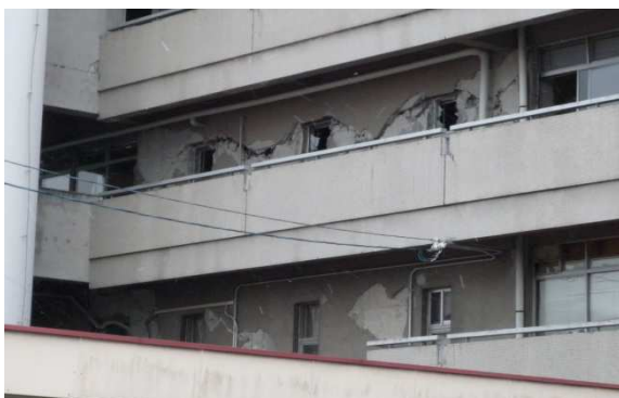
須賀川市役所 せん断破壊
