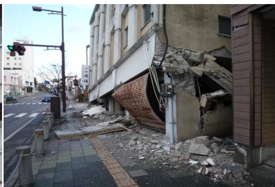
1階が崩壊したRC 3階建
